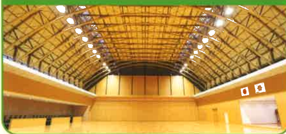
大分県産のスギ製材で70mの大スパンを実現した大分レゾナック武道スポーツセンター
